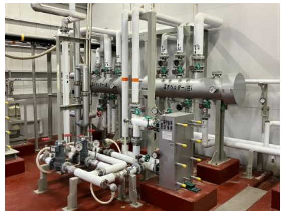
発電によって得られた温水の一部は工場へ供給
