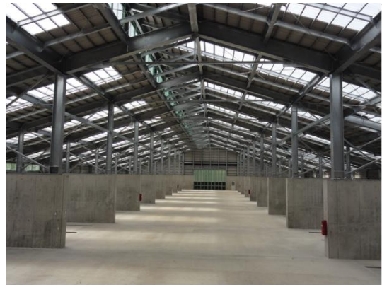
下水汚泥肥料化施設
