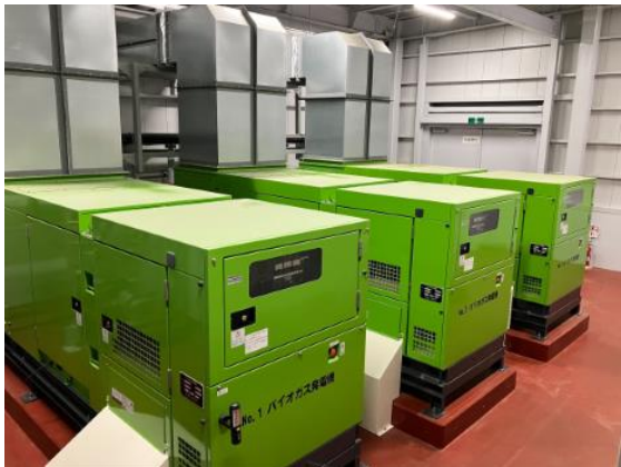
50kw のバイオガス発電機を 3 台設置
