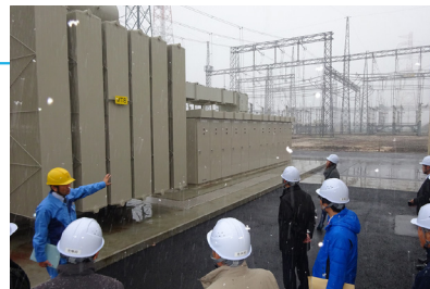
西仙台変電所
