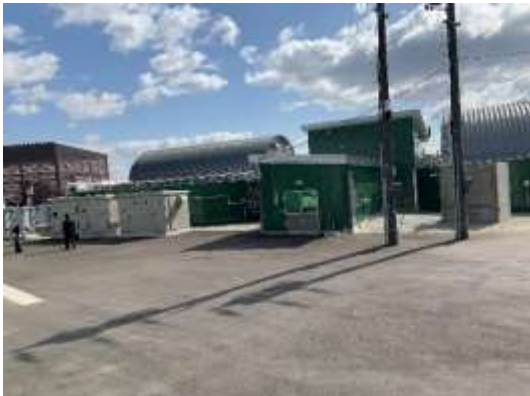
発電プラント
